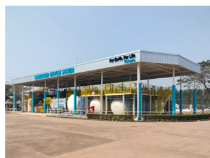
Kubota Engine (Thailand) Co., Ltd.では、膜分離活性汚泥法(MBR)による排水処理システムを増設し、排水を場内散水や生活用水に再利用しています。
