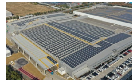
中国工場の屋根に設置した太陽光発電システム
