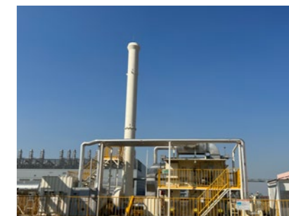
久保田発動機 (無錫) 有限公司 (中国) では、RTO (蓄熱式脱臭装置) を導入し、VOC排出量の削減に取り組んでいます。
