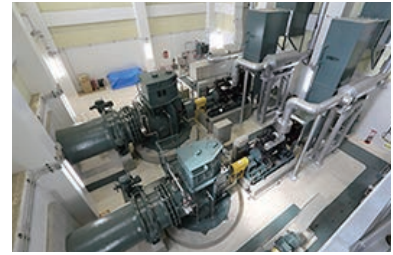
ポンプ(緊急排水をはじめ、大雨による浸水や高潮による浸水への対策として利用)
