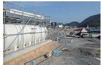
浄化槽(下水道が整備されていない地域、仮設住宅等の排水処理に活用)
