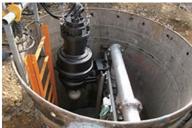
マンホールポンプ(下水を圧送)
