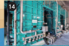
14 セラミック膜 河川や水源地の水を高度浄化処理し、飲料水をつくります。
