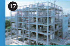
17 下水污泥焼却炉 下水処理の際に発生する汚泥を焼却・熔融するプラントです。
