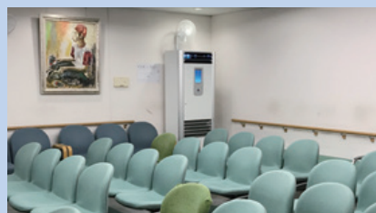
病院待合室での設置例
