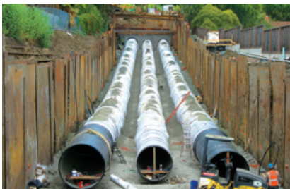
洪水被害から生活を守る 雨水排水ポンプ
