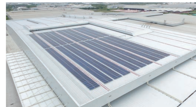
屋上に設置した出力510.3kW相当の太陽光パネル
