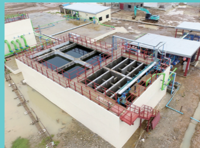
ティラワ工業団地Zone AIに施工した浄水場
