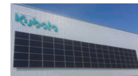
壁面に設置した出力25.2kW相当の太陽光パネル
