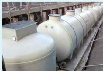
浄化槽 下水道が整備されていない地域の排水処理を行います。
