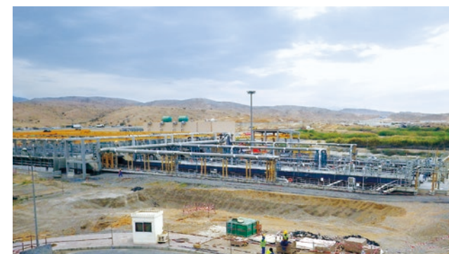
アルアンサブ下水処理場(オマーン)
