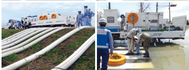
2015年台風18号による水害現場 (画像提供:国土交通省関東地方整備局)
