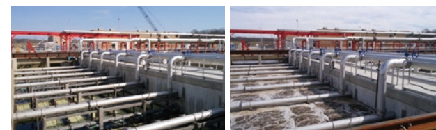
クボタの膜装置が設置された水再生処理施設(左:稼働前、右:稼働中)
