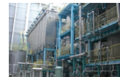
水処理プラント
