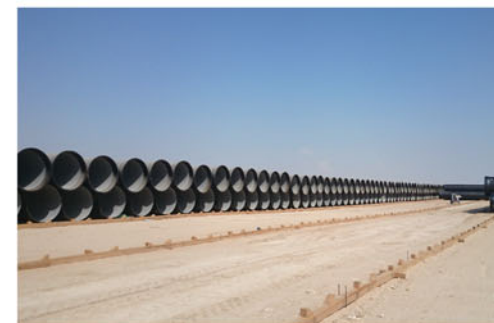
送水管として使用されるダクタイル鉄管
