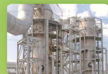
排煙脱硫・排煙脱硝装置
