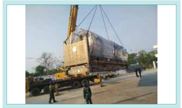
図6 現場荷下ろし状況(薬品タンク) Fig. 6 Unloading at Site (Chemical Tank)
