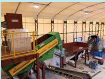
図3-1 前処理(破碎分別)設備 Fig. 3-1 Pretreatment
