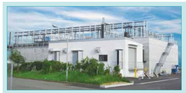
図3 納入した排水処理設備(規模 2500 m 3 /日)
