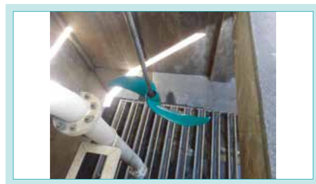
図 10 D 下水処理場兼用槽
