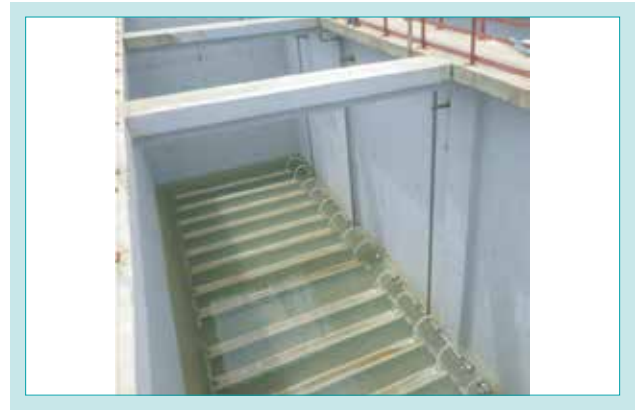
図 13 ミャンマーティラワに導入された K メンブレン Fig. 13 K-membrane Installed in the Thilawa SEZ Zone
