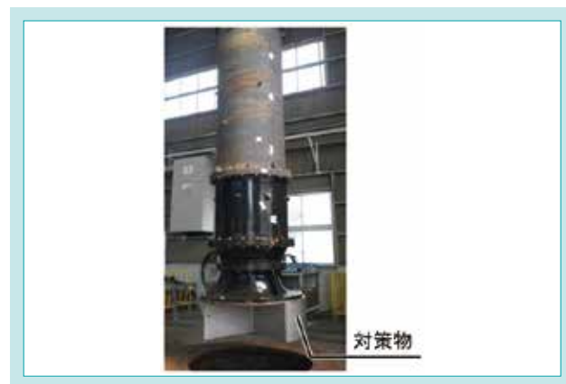
図 11 実験ポンプと対策物 Fig. 11 Test Pump and the Development Structure
