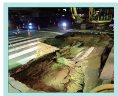
図1 道路陥没事故事例
