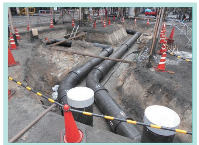
図2 海水取水管への設置例(呼び径450ポリエチレン管) Fig. 2 PE Pipe for Seawater Intake (ND 450 mm)
