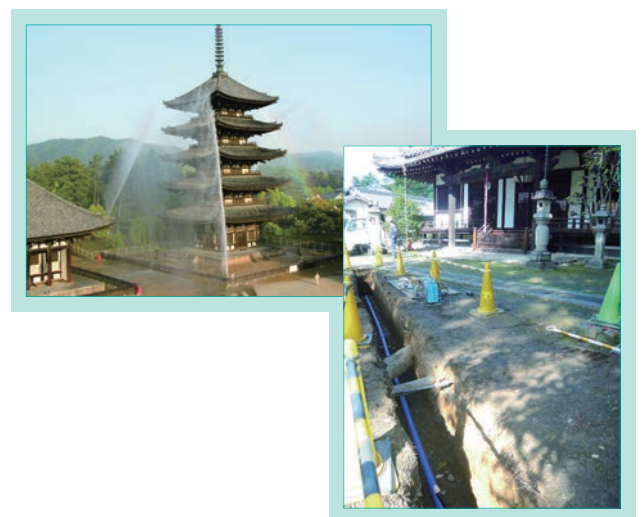
図1 寺社消火配管への設置例(呼び径50ポリエチレン管) Fig. 1 PE Pipe for Firefighting Line in Shrine (ND 50 mm)
