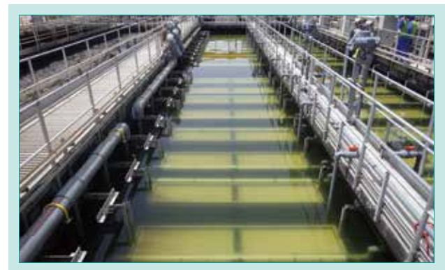
図8 膜分離槽内の全景
