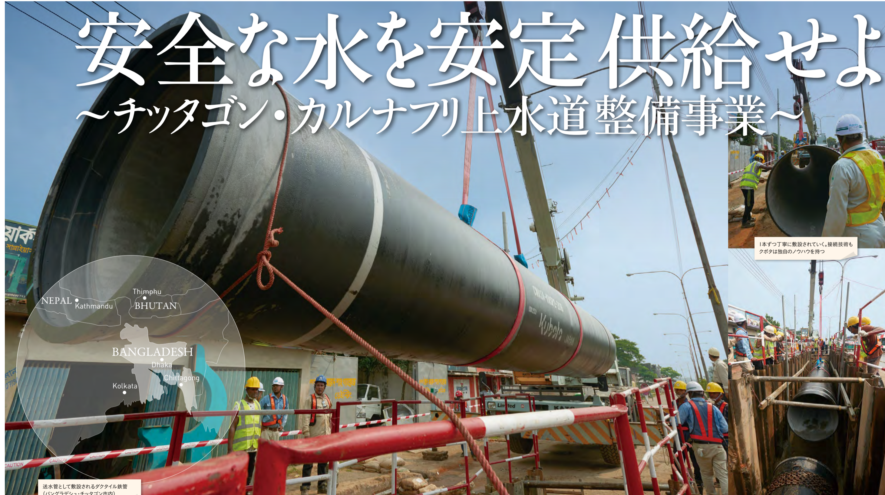
送水管として敷設されるダクタイル鉄管 ( Bangladesh・チッタゴン市内)
